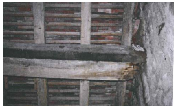
Panne atteinte par des infiltrations
